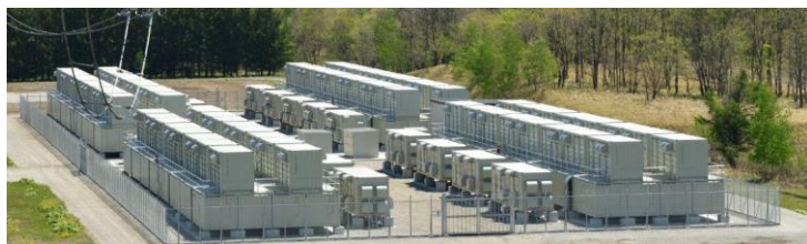
引用:住友電気工業(株)様のレドックスフロー電池基地より https://sumitomelectric.com/jp/products/redox
