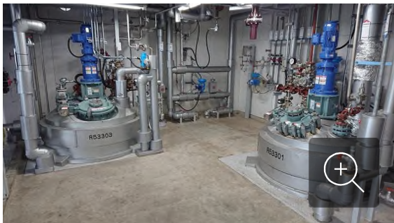
有機ELデバイス用の次世代偏光板製造に必要な化合物の生産が始まった新開発プラントの内部＝小西化学工業提供
